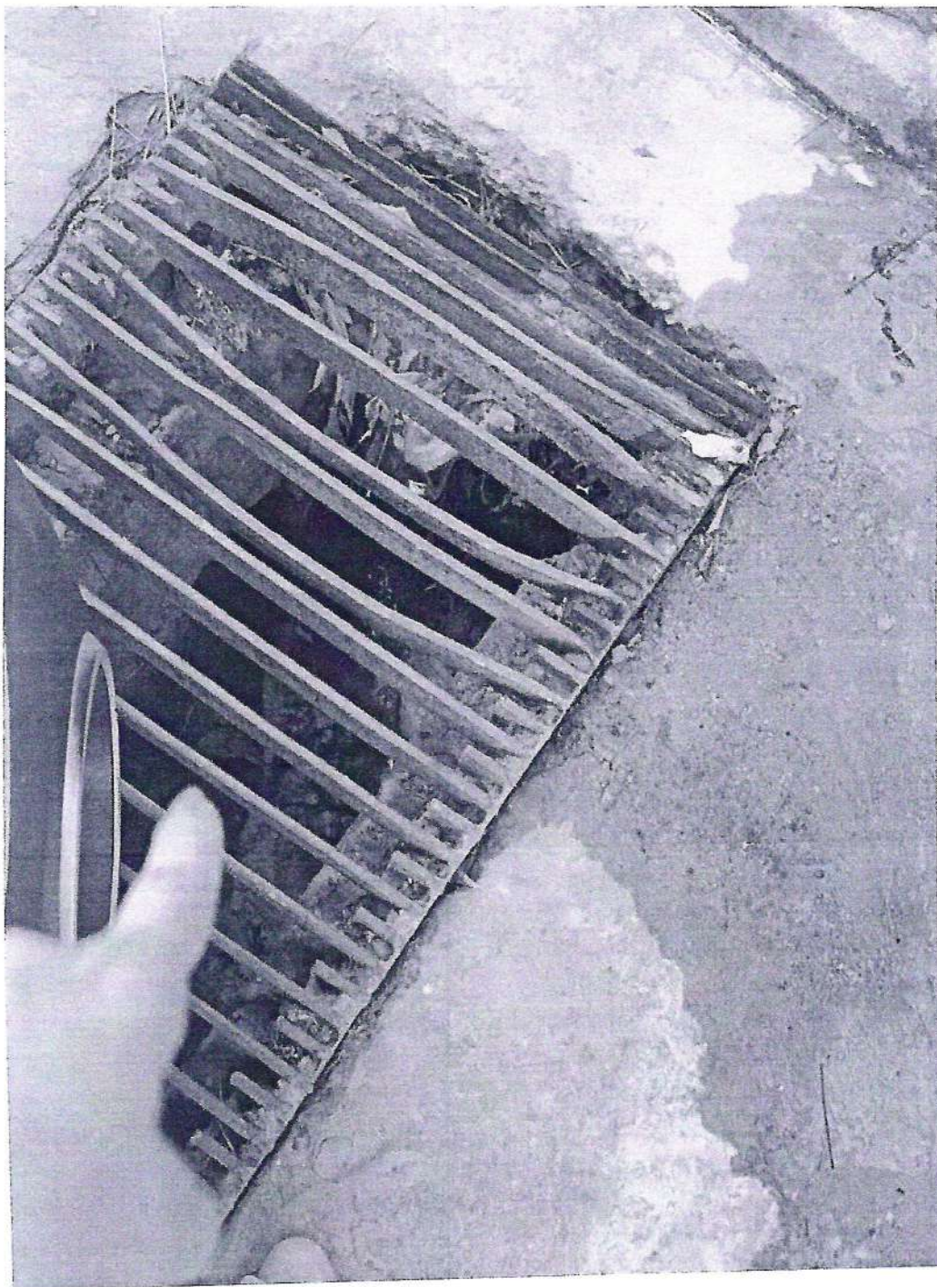
Foto 2 – Boca de lobo danificada
