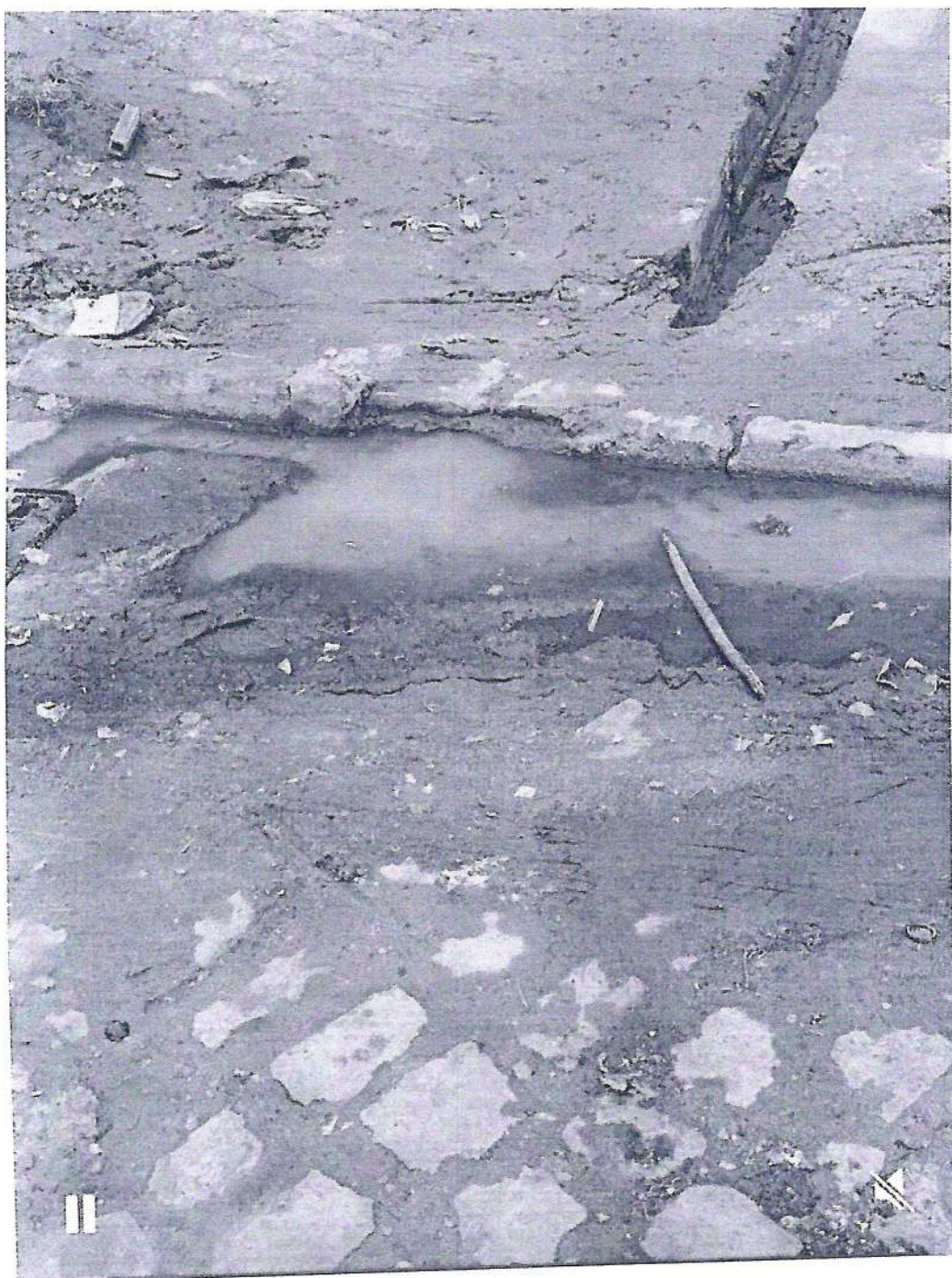
Foto 3 – Área afetada pelo alagamento
