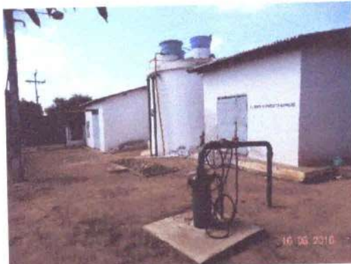
Figura 4.2 - Poço PT-01 – SSD de Porteiras
