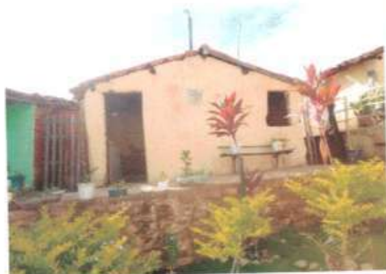
Foto 16: Edificação residencial da Vila Cancela construída em pau-a-pique em ruim estado de conservação.
