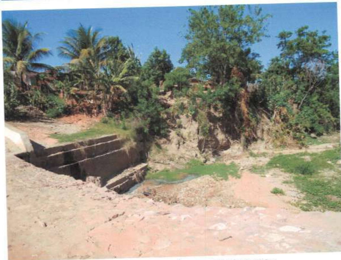
Foto 67: Ocupações em risco às margens do Riacho Vieira.
