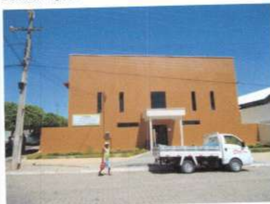
Foto 54: Centro de Referência em Assistência Social (CRAS), localizada à Praça da Liberdade, no Bairro Centro, apresentando-se em bom estado de conservação.
