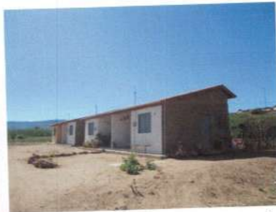
Foto 62: Edificações residenciais em ruim estado de conservação no final da R. Francisco Gonçalves, no Bairro Entre Rios.
